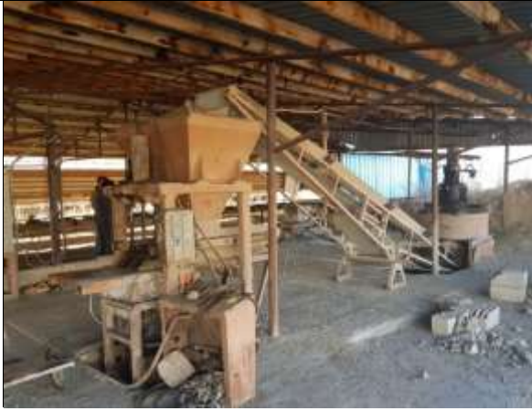
Оборудование для производства шлакоблоков (формы для шлакоблоков, бетономешалка, вибрационная установка, пресс, конвейер), 2006 г/в.
