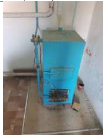
Котел отопительный в цехе по производству пластиковых окон литер Ю, 2007 г/в.
