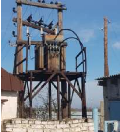
Трансформаторная подстанция, 1957г/в.
