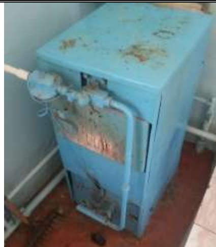
Котел отопительный в административном здании литер А, 1990 г/в.
