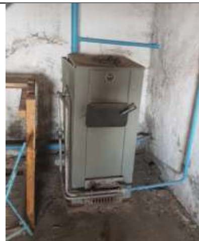
Котел отопительный КС-ТГ-25, в токарном цехе литер Т, 2000 г/в.
