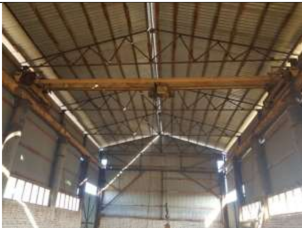
Кран-балка с подъемным механизмом, грузоподъемность 3100к, 2006 г/в.
