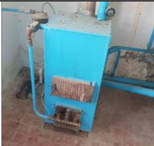
Котел отопительный в здании бытовых помещений литер В, 1990 г/в.
