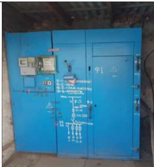
Оборудование электрощитовой, 2015 г/в.
