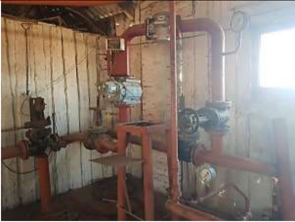
Узел учета газа кольцевой печи Roots (ротационный счетчик газа Roots Meter, электронный корректор объема газа Roots Micro Series, фильтр газа), 1996 г/в.
