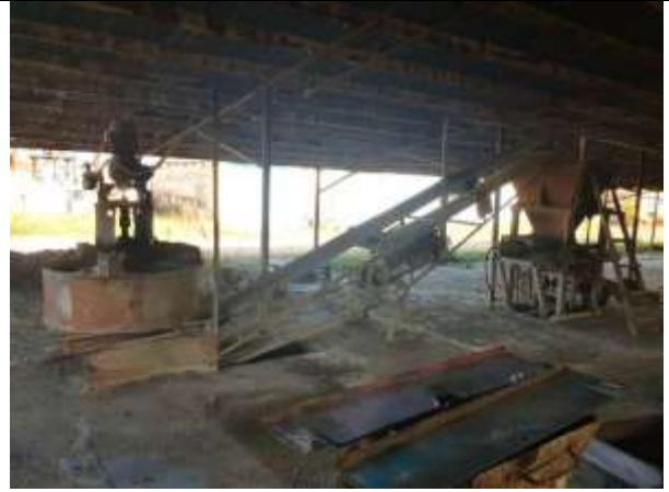
Оборудование для производства шлакоблоков (формы для шлакоблоков, бетономешалка, вибрационная установка, пресс, конвейер), 2006 г/в.
