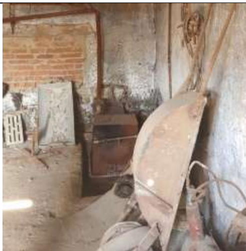
Котел отопительный в сварочном цехе литер Ф, 1990 г/в.
