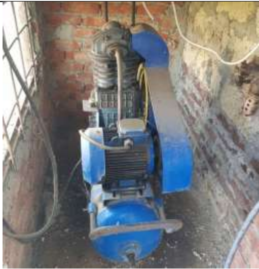
Поршневой компрессор с ременным приводом, 2007 г/в.
